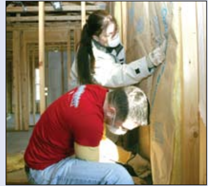
La insulación de edificios puede atraer ahorros significativos de energía. En los EE.UU., un 70% de consumo de electricidad proviene de los edificios.
